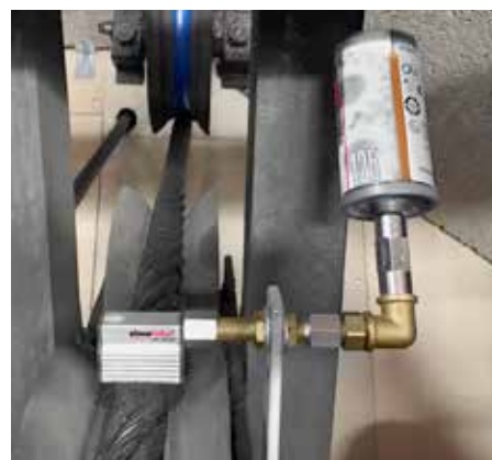
Трос канатной дороги смазывается лубрикатором simalube. Смазка наносится щеткой, а трос очищается.
